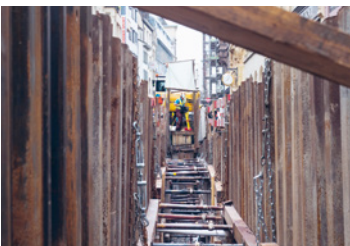
ABB. 6 Seit August 2020 werden in der Freien Strasse Fernwärmeleitungen verlegt. Die Ausgrabungen in den schmalen Leitungskanälen stellen hohe Ansprüche an die Dokumentation und erfordern eine intensive Absprache mit der Bauleitung. Foto: David Roth.
