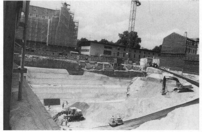
Abb. 25. Petersgraben 49/51, Rosshofareal, 1983/15; Fundstelle Nr. 25. Das Stadtmauerfundament «schwebt» über der Baugrube. – Foto: Dokumentation 1983/15.
