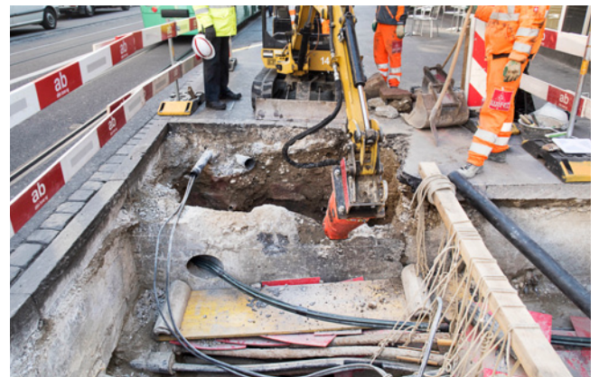
ABB. 12 Hinter einem modernen Leitungsschacht, der abgespitzt wird, werden Mauerreste aus rotem Sandstein sichtbar. Foto: Birgit Lißner.
