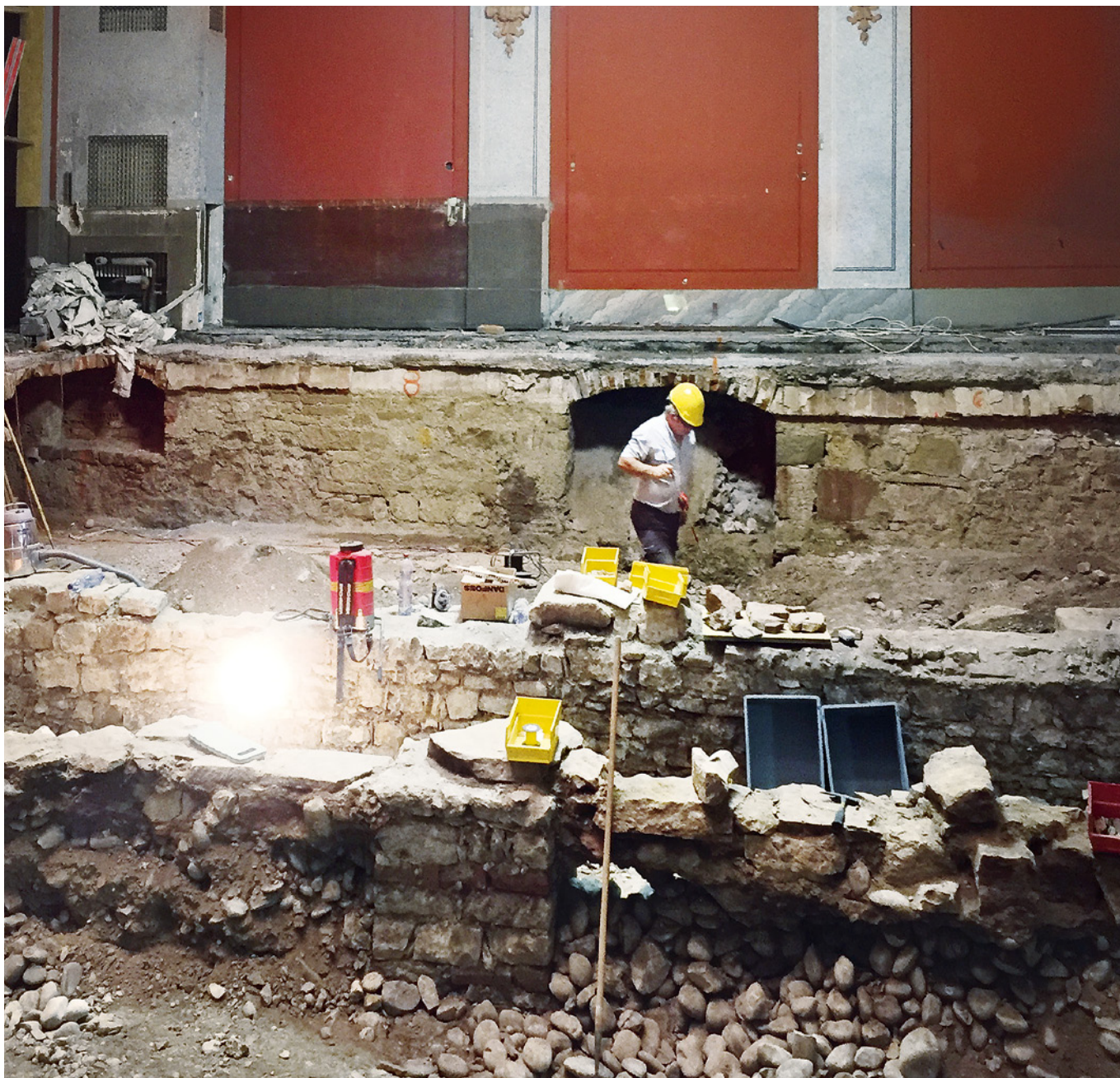
ABB. 9 Bereits einen halben Meter unter dem Konzertsaalboden wurden erste Befunde aufgedeckt: Die hofseitige Mauer des Verwaltungsgebäudes des Kaufhauses und ein Punktfundament der Pfeilerkolonnade. Foto: Guido Lassau.
