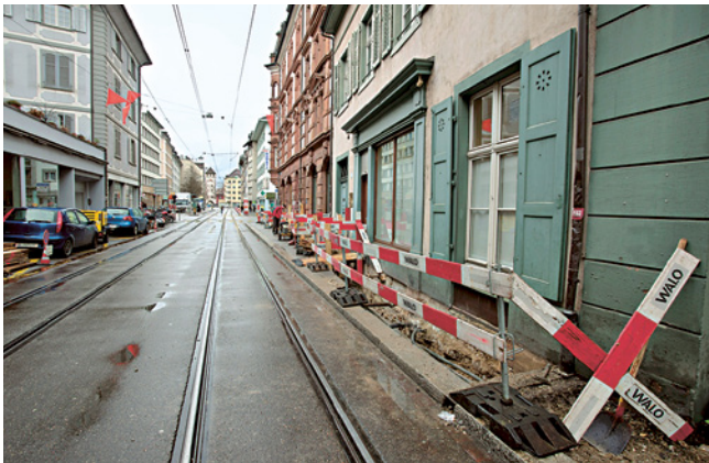
ABB. 8 Für die Erneuerung der Werkleitungen auf der Rheinseite der St. Johannns-Vorstadt wurde ein Graben entlang der Häuserfronten geöffnet. Foto: Benedikt Wyss.
