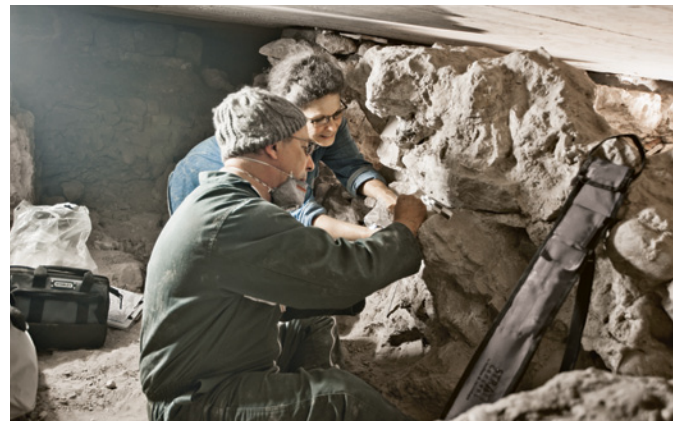
Abb. 10 Pierre Guibert und Claude Ney bei der Entnahme der Mörtelproben im südlichen Querhausarm des Münsters. Foto: Marco Bernasconi.
