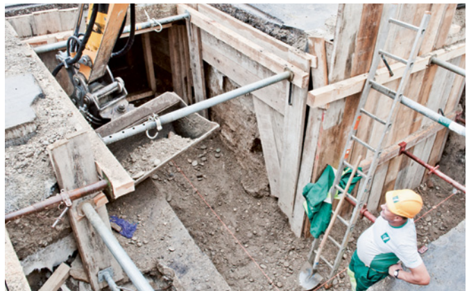
Abb. 37 Eine Strassenquerung für die Fernheizung zeigt im nicht verschalteten Bereich eben noch die verputzte Kellermauer eines längst abgebrochenen Gebäudes aus dem 19. Jh. Foto: Christoph Matt.
