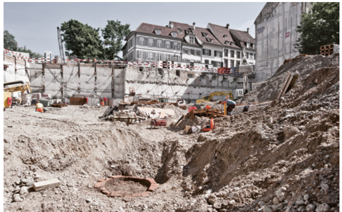
Abb. 21 Blick in die Baugrube des neuen Kunstmuseums in Richtung Wettsteinbrücke (im Hintergrund die Kopfbauten der St. Alban-Vorstadt). Foto: Christian Stegmüller.
