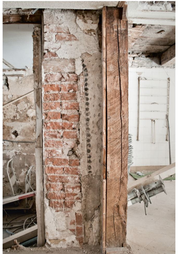
Abb. 26 Ein spätmittelalterlicher Bollenfries säumt eine mit Backsteinen zugemauerte Binnentüre – letzte Reste einer beidseits amputierten Binnenmauer. Foto: Christoph Matt.
