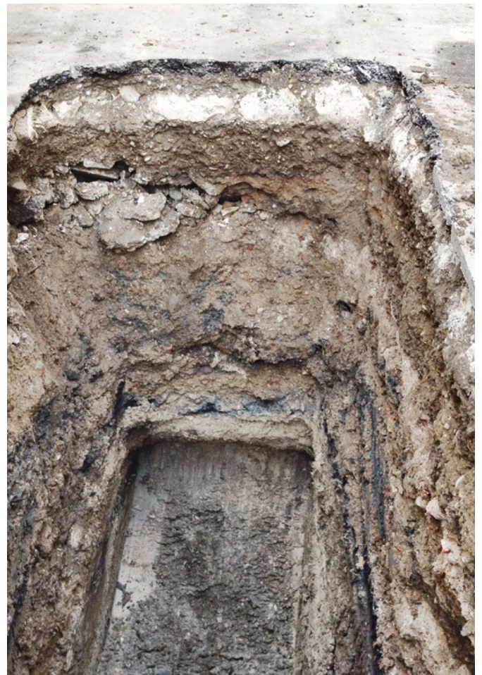
Abb. 32 Fotografische Dokumentation eines engen und tiefen Schachtes in der Kraftstrasse. Foto: Norbert Spichtig.
