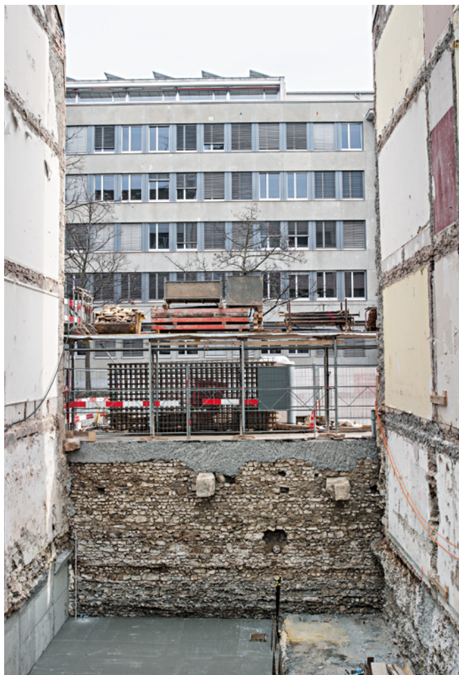
Abb. 33 Blick stadteinwärts auf die (ursprünglich nicht sichtbare) Rückseite der Kontermauer nach Abbruch des Gebäudes. Die beiden grossen vorkragenden Ankersteine und der etwas kleinere links oben auf Strassenniveau gehörten zu einem Keller des 19. Jahrhunderts. Die Störung darunter zwischen den beiden grossen Steinen geht auf die alte Kanalisationsleitung zurück. Foto: Christian Stegmüller.
