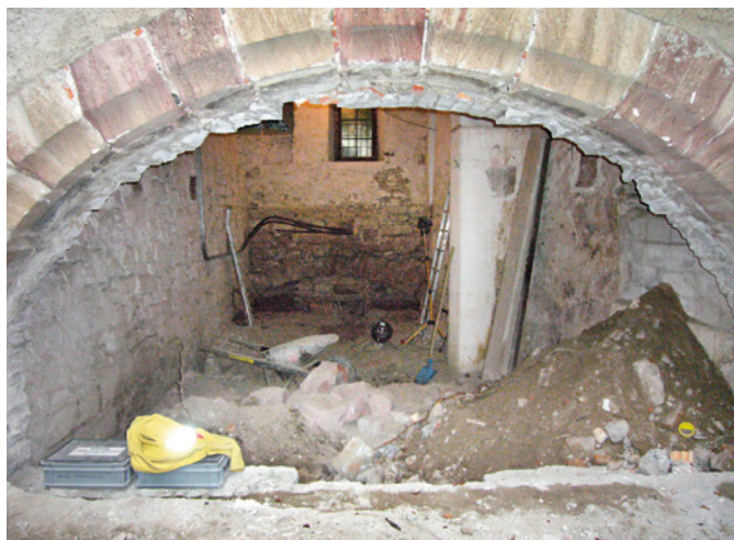
Abb. 54 Blick von aussen durch den aufgebrochenen alten Teicheinlass in den neuen Keller (ehemaliger Teich) in Richtung Rhein. Foto: Christoph Matt.
