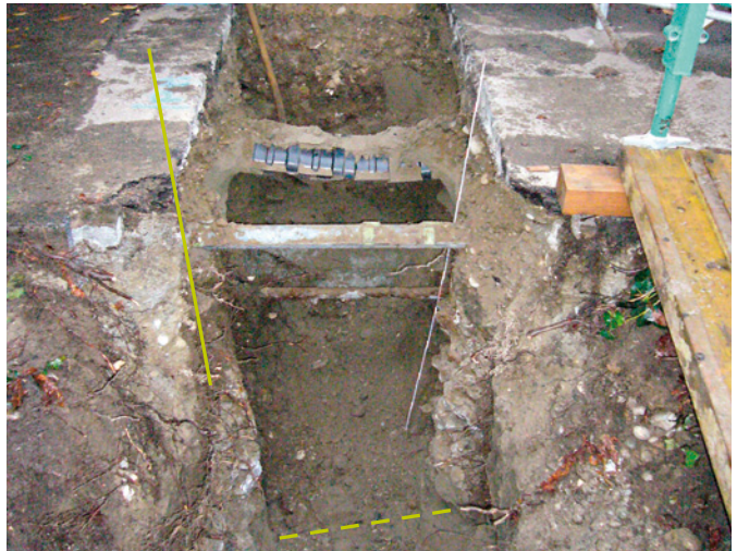
Abb. 58 Blick nach Norden auf den Leitungsgraben mit dem leicht schräg in den Graben ziehenden (durchgehende Linie) und dem abgebrochenen (gestrichelte Linie) Mauerfundament. Foto: Christoph Matt.
