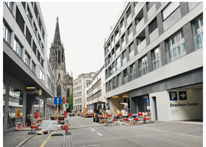
Abb. 52 Die Baustelle an der Henric Petri-Strasse, in einem Areal, wo schon verschiedentlich Funde des spätrömisch-frühmittelalterlichen Gräberfeldes zum Vorschein gekommen sind. Rechts die Einfahrt ins Drachencenter, bei dessen Neubau 2007 gut erhaltene spätrömische Gräber entdeckt wurden. Foto: Christian Stegmüller.
