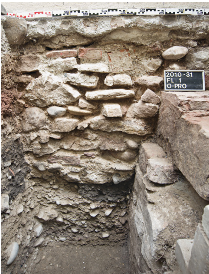
Abb. 27 Unter dem Fundament zeigt sich der Rest einer römerzeitlichen Grube, links im Bild ausplanierete Schuttschichten. Foto: Jan Baur.
