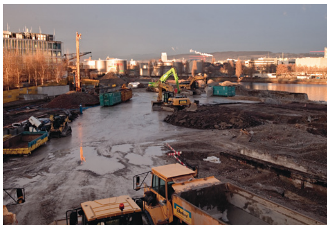
Abb. 85 Bei besonderen Wetterverhältnissen erstrahlt die Umgebung der Grossbaustelle wie im Scheinwerferlicht. Die verschiedenen Grabungsflächen von 2010/37 sind in diesem mittleren Abschnitt des ehemaligen Rheinhafens verteilt. Der Bagger im Zentrum legt eine kleine Teilfläche frei; weiter hinten links ist eines der Grabungszelte zu sehen. Foto: Michael Wenk.
