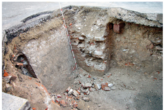
Abb. 56 Zu Beginn der Tiefbauarbeiten wurde an der Ecke Spalenberg/Schnabelgasse der Keller des um 1900 abgerissenen Hauses «Zum Hauenstein» (ehemals Schnabelgasse 1) freigelegt. An der Wand hinten ragt noch ein Konsolstein der Balkendecke heraus. Foto: Christoph Matt.
