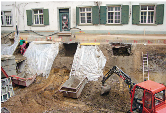
Abb. 57 Die dem Barockflügel vorgelagerte Böschung enthielt noch einige ältere Mauerfundamente und mittelalterliche Kulturschichten. Foto: Christoph Matt.
