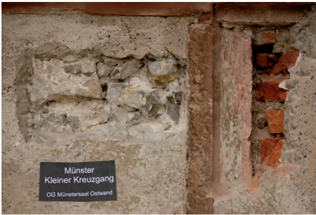
Abb. 3 Münster, Münstersaal-Ostfassade. Wandsondierung am südlichen Gewändepfosten der zugemauerten Öffnung (siehe Abb. 1), die zum Originalbestand der Fassade gehört. Auf der Gewändekehle sind auf weisser Tünche grüne Farbreste erhalten. Der Ladenfalz beschneidet nicht nur die Kehle, sondern auch die Farbschicht. Damit erweist er sich als sekundär. – Foto: Matthias Merki.
