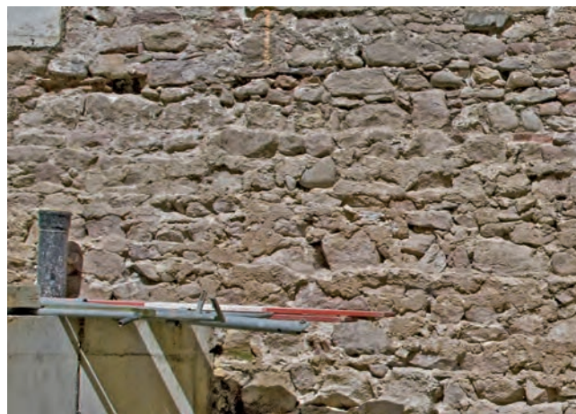
Abb. 17 Klosterberg 9. Westliche Hofmauer. Der untere Bereich der neuzeitlichen Mauer (18. Jahrhundert) stand ursprünglich im Boden. Gut erhalten sind die Abdrücke horizontaler Schalungsbretter. – Foto: Philipp Ryffel.
