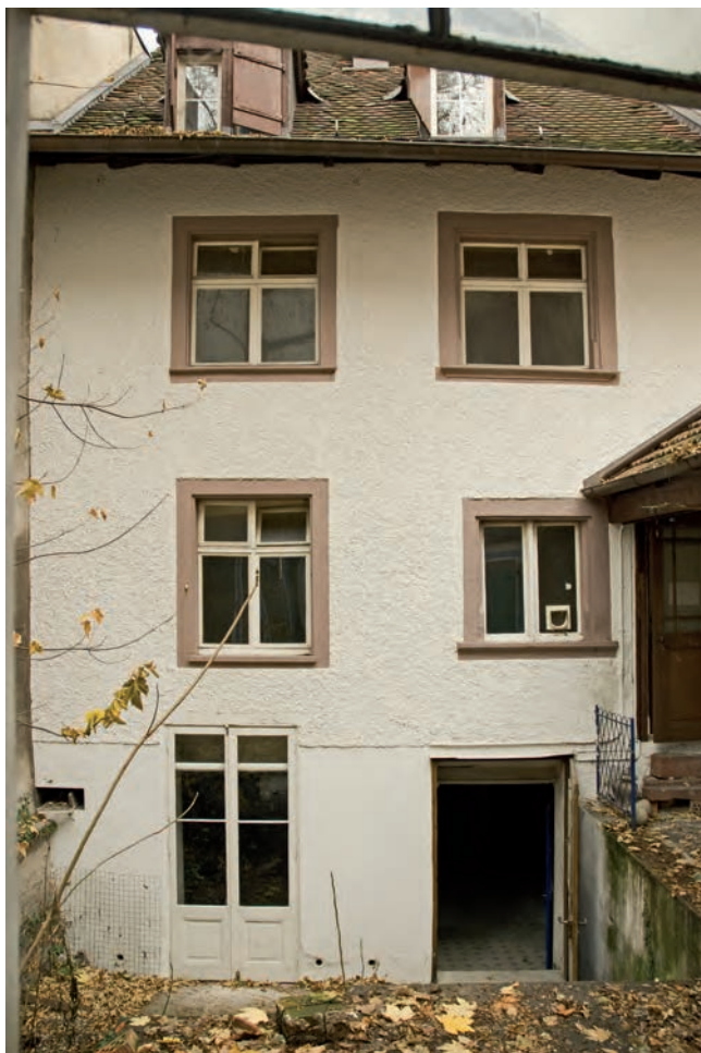
Abb. 5 Klosterberg 9. Hoffassade. Im Vordergrund der hoch liegende Teil des hinteren Hofes und rechts aussen dessen Erschliessung über die Laube durch die eingezwängte Türe im 1. OG. In der rechten Fensterachse sind die wieder verwendeten gotischen Gewände zu sehen, wobei das obere Gesims mit Wulst und abgesetzter Kehle barock ausgeformt ist. Die Türe im EG links ist eine moderne Erweiterung einer ehemaligen Fensteröffnung. – Foto: Matthias Merki.
