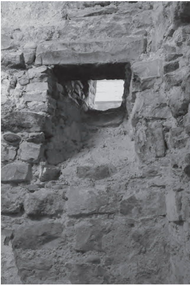
Abb. 19 Blumenrain 28. Ursprünglich angelegte Rauchabzugsöffnung am Baukörper von 1335 (Freilegung an der Innenseite der rheinseitigen Aussenmauer im 2./3. UG). Die aussen schlitzartige Öffnung wird innen breiter und zieht sich schräg nach unten (siehe Kapitel 3.3). – Foto: Daniel Huber.
