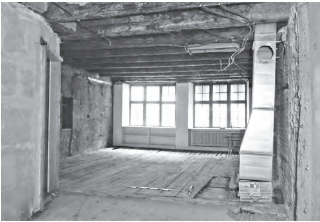
Abb. 4 Gerbergasse 55. Blick im 1. OG zur Gerbergasse. Zustand 1997. Die Fenster aus spätgotischer Zeit sind mit barocken Fensterflügeln versehen. Die Decke der einstigen Stube ist an den Balken roh belassen, was auf eine untergehängte Vertäferung hindeutet. Die Wände sind entsprechend mit einem rohen Bewurf aus feinsandigem Putz überzogen. An beiden Brandmauern ist je eine Wandnische eingelassen, deren dazu gehörende Wandtäfer und Nischenverkleidungen fehlen. Der historische Boden mit Gehspuren besteht aus breiten Tannenriemen. Die das Zimmer abschliessende Innenwand (im Bildvordergrund ist deren Schwellenbalken zu erkennen) war als Fachwerkkonstruktion ausgebildet. Davon hat sich ein Fragment als Seitenwand des Liftschachts erhalten. Der Schwellenbalken wurde 1997 entfernt. – Foto: Daniel Reicke.
