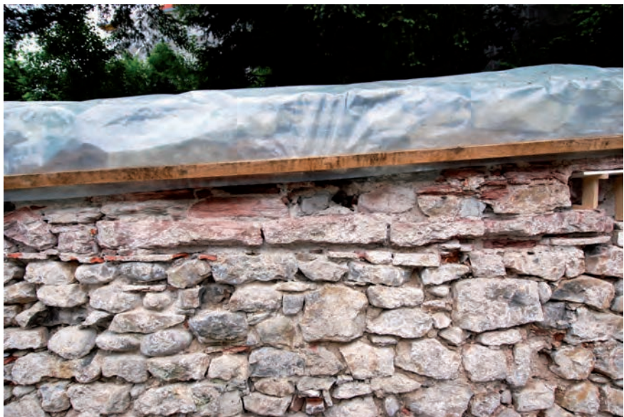
Abb. 6 Mühlenberg 12 / St. Alban-Vorstadt 65, 69, 71. Ausschnitt von Teil 3 der Mauer. Die nachträgliche Aufstockung ist gut zu erkennen. Darunter liegt ein durchgehendes Band aus ca. 10 cm dicken Buntsandsteinplatten, welche als ehemalige Abdeckung der Mauer dienten. – Foto: Bernard Jaggi.
