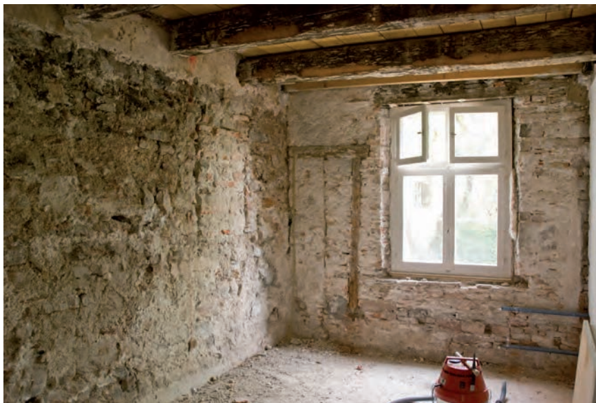
Abb. 8 Unterer Heuberg 7. Haus West, EG, nordwestlicher Raum (Gartenseite). Die freigelegten Mauern zeigen links mittelalterliches Mauerwerk in der Brandmauer mit Brandschäden (13. Jh.). Im Hintergrund eine eingebrochene, später zugemauerte Nische. Darüber die sekundär eingelassenen Deckenbalken von 1384. Hinten die Gartenfassade mit einer nachträglich vermauerten Türöffnung (Holzsturz und Leibungskante). – Foto: Bernard Jaggi, 2008.
