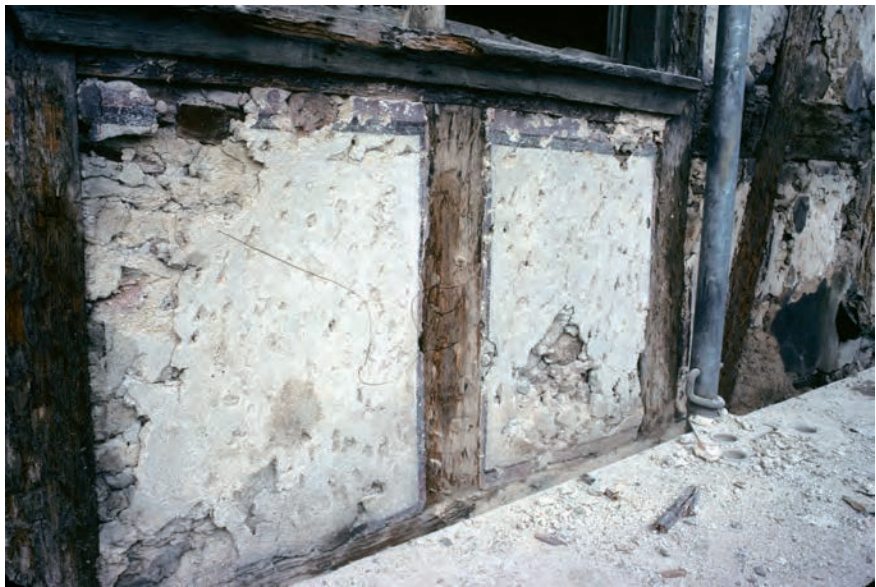
Abb. 20 Unterer Heuberg 7. Haus Ost, 2. OG, Fachwerkfassade mit integriertem Fenster. Auf dem Verputz hat sich die Farbfassung der in Caput mortuum gestrichenen Hölzer erhalten. Der verbreiterte Begleitstrich am oberen Rand der Felderumrahmung unter der Brüstung erzielt eine perspektivische Wirkung. – Foto: Bernard Jaggi, 1978, Archiv DPFBS.
