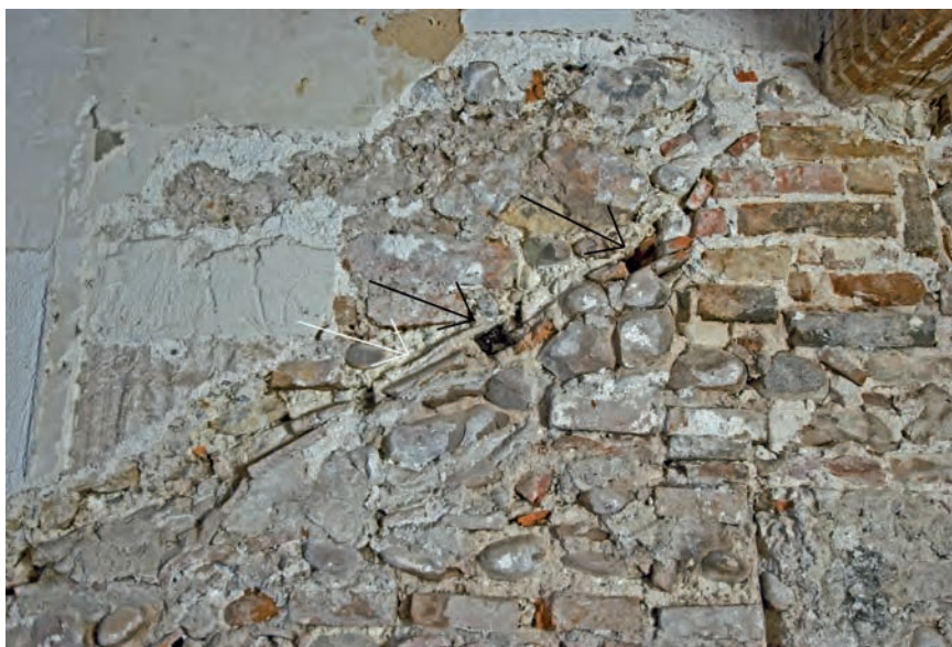
Abb. 15 Klosterberg 9. Erstes DG, Westbrandmauer. Aufmauerung der 3. Bauphase von Klosterberg 9 mit erhaltener Dachlinie. Die schwarzen Pfeile weisen auf zwei verkohlte Reste originaler Dachlatten. Der weisse Pfeil zeigt auf den Abdruck eines Hohlziegels in feinsandigem Abstrichmörtel. – Foto: Matthias Merki.
