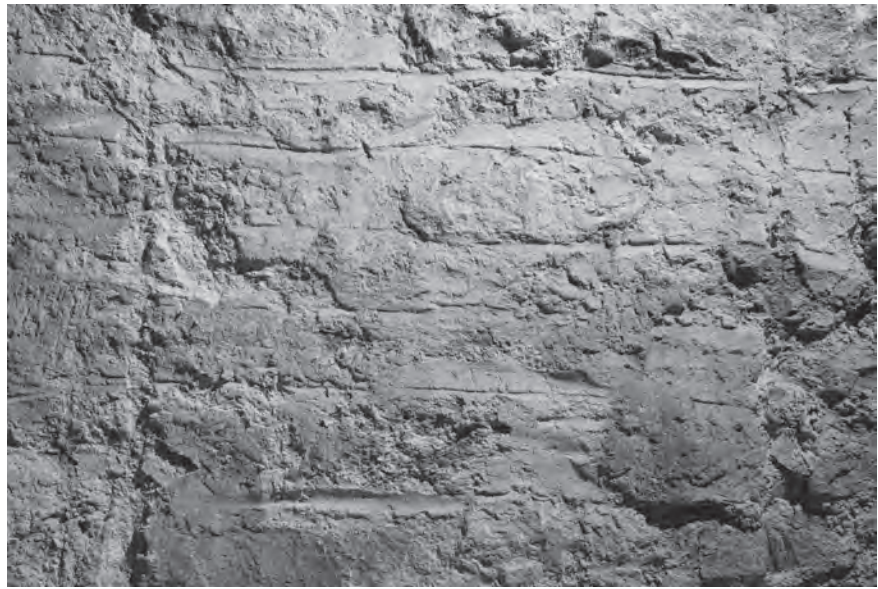
Abb. 9 Blumenrain 28. Fugenstrich am quer zum Fluss stehenden Abschnitt der Uferbefestigung A (2. UG). Der Mauermörtel ist glattgestrichen und mit Kellenstrichen markiert. Diese Art der Fertigstellung ist an der gesamten, dem Fluss zugewandten Flanke des Mauerzugs A feststellbar und bis ins 1. OG fragmentarisch erhalten. – Foto: Conradin Badrutt.
