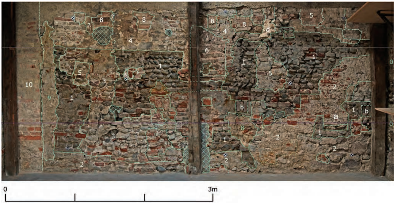
Abb. 3 Lindenberg 17/19. Nördliche Hofmauer auf der Parzelle Lindenberg 19 gegen das heute überdeckte Höflein des Restaurant Rebhaus an der Riehentorstrasse 11 (siehe Abb. 4). Die wegen der Salzschäden häufig geflickte Mauer zeigt an der Oberfläche nur noch wenig Originalsubstanz (1, leicht abgedunkelt), zu der die Nische a und die Gerüstlöcher b gehören. Das zentrale (später zugemauerte) Fenster ist Teil der Bauphase 4, zu der auch die Kalkmörtelformsteine gehören (d, aufgehellt). Die Nische und die zugemauerten Balkenlöcher 8 belegen, dass hier schon früher ein Bau stand. – Foto: Matthias Merki. Bearbeitung: Matthias Merki, Hans Ritzmann.
