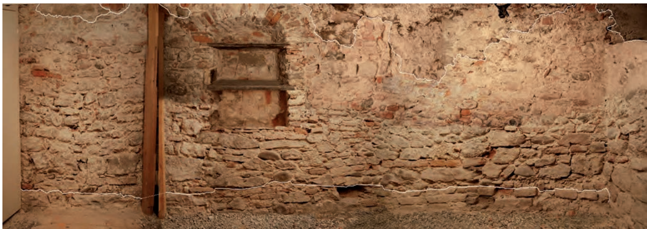
Abb. 10 Unterer Heuberg 7. Haus West, Kellermauer Süd. Die Mauer überspannt die Breite des rückwärtig angelegten Kellers von der eingerückten Westmauer rechts, mit der sie gleichzeitig entstanden ist, bis zur Brandmauer links, die partienweise älteren Ursprungs ist. Die Kellermauer Süd unterfängt ein im oberen Drittel fragmentarisch überliefertes Mauerfundament (weisse Linie oben), das eine ältere, über dieser Flucht ehemals aufgehende Mauer bezeugt. In der untersten Zone spricht ein 30–40 cm hoher Mauerstreifen für eine nachträgliche Absenkung des Kellerbodens (weisse Linie unten). In der Kellermauer ist eine Nische mit Stichbogen in situ. Mauerwerk und Mörtel der Kellermauer sprechen für eine Entstehung im 16./17. Jh. – Foto: Bernard Jaggi, 2008. Bearbeitung: Matthias Bill.
