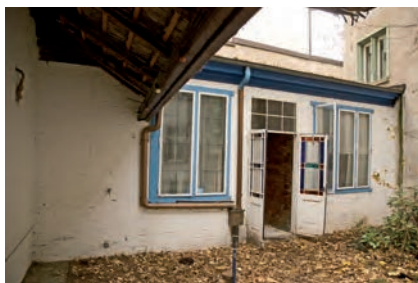
Abb. 6 Klosterberg 9. Werkstatt im hinteren, erhöhten Teil des Hofes. Links das an die östliche Hofmauer angeschleppte Pultdach der Verbindungs-laube zum Vorderhaus. – Foto: Matthias Merki.
