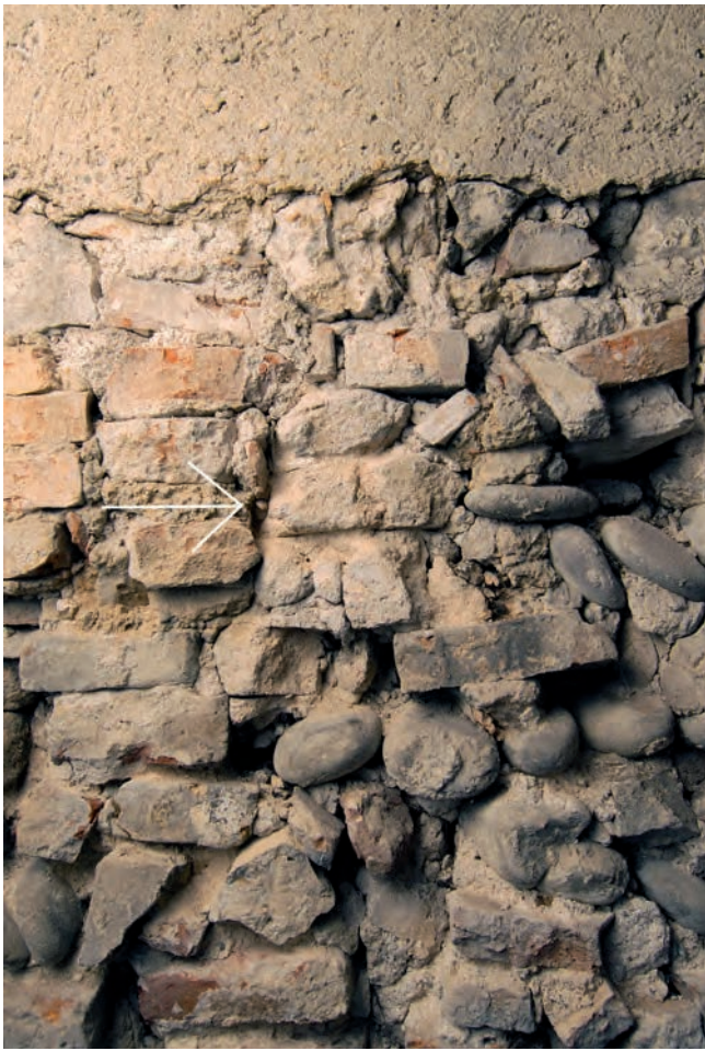
Abb. 6 Lindenberg 17/19. Nördliche Hofmauer. In einer neuzeitlichen Reparaturzone im rechten oberen Mauerbereich (Bauphase 4, d, siehe Abb. 3) sind einige Kalkmörtelformsteine oder Bruchstücke davon eingemauert (weisser Pfeil). Sie bestehen aus feinsandigem Mörtel und haben die Grösse von Backsteinen. – Foto: Matthias Merki.
