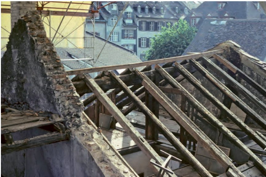
Abb. 13 Unterer Heuberg 7. Abgedecktes Dachwerk von Haus West. Auf der zwischen die Giebelmauern gespannten Firstpfette liegen die Rafen nebeneinander, mit Holznagel fixiert. Der Firstpfosten in der Mitte ist Teil eines mittleren Binders. Im Vordergrund der höhere Giebel von Haus Ost. Das Dachwerk wurde 1979 unter Belassung des mittleren Binders abgebrochen. – Foto: Bernard Jaggi, 1978, Archiv DPFBS.
