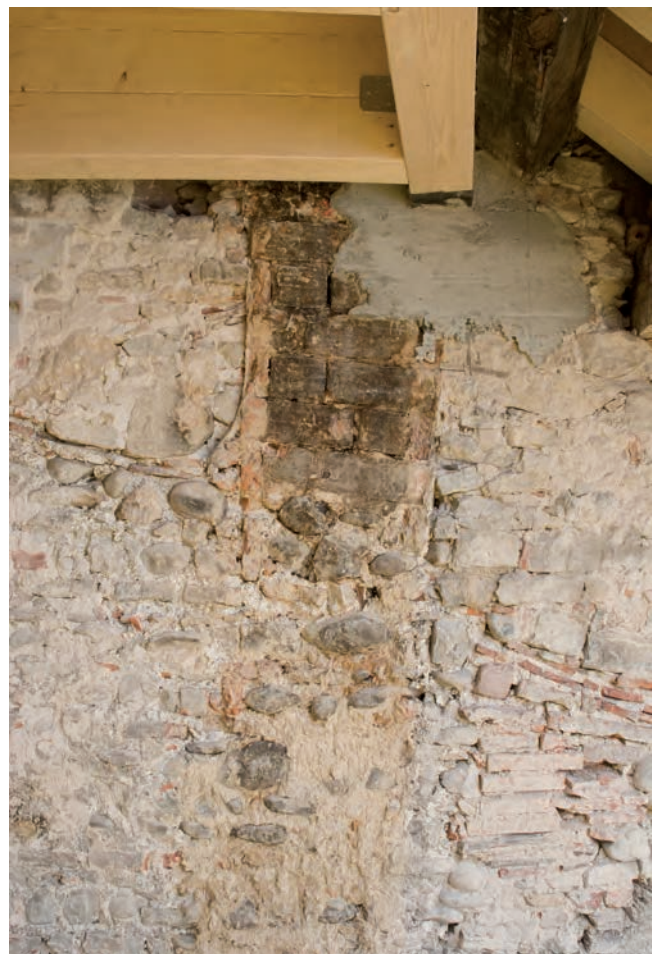
Abb. 22 Blumenrain 28. Dachlinie des Mauerwerks F und Fragment eines alten Schornsteinkopfs des Hauses Nr. 28, der sich über die damalige Dachlinie des Hauses Nr. 30 zog (Freilegung an der nördlichen Brandmauer im rheinseitigen 3. OG). Die nördliche Schornsteinwand ist in der Brandmauer-Erhöhung von 1587 erhalten geblieben. Die anderen Schornsteinwände wurden erst viel später abgebrochen. – Foto: Daniel Huber.
