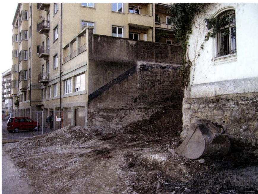
Abb. 1 St. Johanns-Rheinweg 115, 2005/29. Ein Blick vom Rheinweg aus auf die Baustelle: Unter der Baggerschaufel zeichnet sich die ungefähr auf der Parzellengrenze liegende Stadtmauer ab. – Foto: Christoph Philipp Matt.
