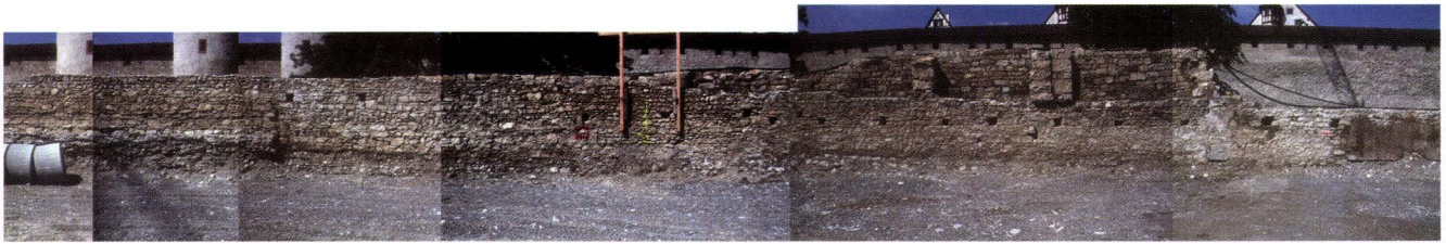
Abb. 16 St. Alban-Rheinweg 108–120, 2005/5. Die Rückseite der Kontermauer. Die Abbildung entstand durch das Zusammensetzen mehrerer Fotos. – Fotos und Zusammenstellung: Catrin Glaser.
