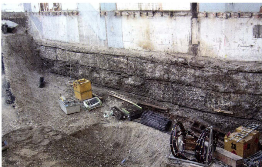
Abb. 23 Dufourstrasse 36, 2005/14. Die südliche Brandmauer, eine Betonmauer des 20. Jahrhunderts, zeigt die Spuren einer in Etappen durchgeführten Unterfangung, die bei der Anlage des Kellers des Nachbarhauses Dufourstrasse 38 nötig wurde. – Foto: Christoph Matt.
