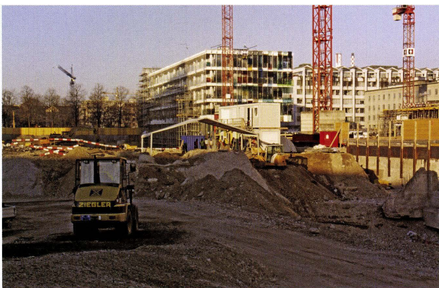
Abb. 1 Nach Abschluss der Bauarbeiten für den «Campus des Wissens» der Novartis werden nur noch ganz wenige Zeugnisse der spätlatènezeitlichen Siedlung im Boden bleiben. – Foto: Philippe Wernher.
