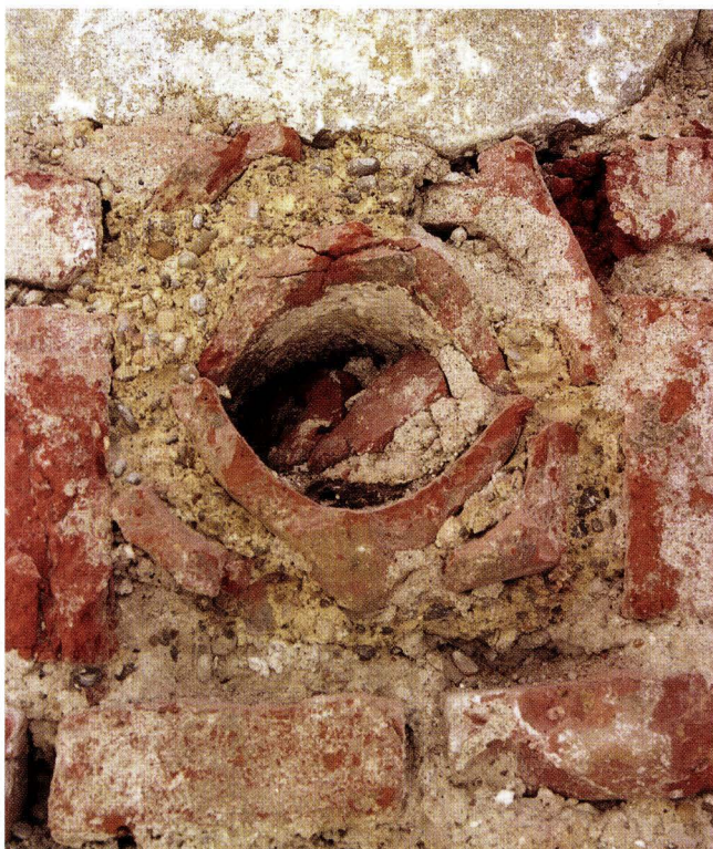
Abb. 11-5 Spalenberg 18 (2004/4). Strassenseitige Fassade, 1. Obergeschoss. Die Gerüstbalkenlöcher wurden mit Hohlziegeln vermauert, welche durch ihre Anordnung eine runde Aussparung freiliessen. – Foto: Basler Denkmalpflege.
