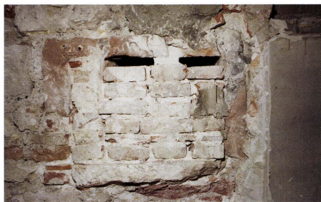
Abb. 11-8 Spalenberg 18 (2004/4). Blick gegen die talseitige Brandmauer im Erdgeschoss. Rechteckig ausgehöhlter Sandstein in Trogform, welcher als Wandnische wiederverwendet wurde. – Foto: Basler Denkmalpflege.
