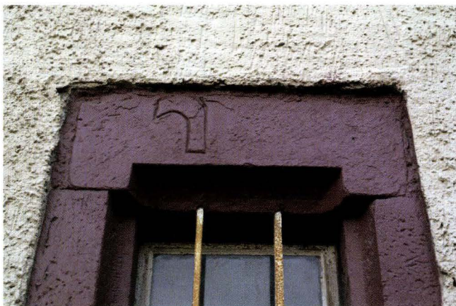
Abb. 10-6 Rössligasse 7, Riehen (2003/381). Kleines Fenster in der Hinterfassade, das ursprünglich den leicht erhöhten Abstellraum über der Kellertreppe beleuchtete. Das im Sturzstein eingemeisselte Rebmesser erinnert an den Bauernbetrieb. Die für den Sturz zu weit auseinander geschobenen Seitengewände sprechen für eine Zweitverwendung der Gewändesteine an diesem Ort. – Foto: Basler Denkmalpflege.
