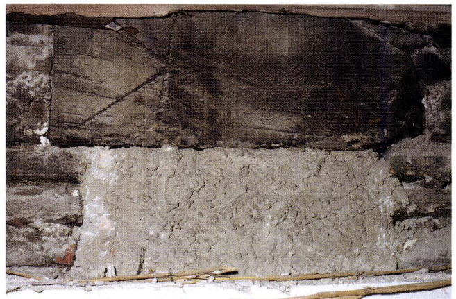
Abb. 11-10 Spalenberg 18 (2004/4). Strassenseitige Mauer, Innenansicht im 1. Obergeschoss. Eines der zwei kurzen, aber stark dimensionierten Sturzhölzer der heute vermauerten Öffnungen, welche sich über den Fensteröffnungen befanden. Das hier gezeigte Holz trägt eine über die ganze Balkenstärke eingekerbte Handelsmarke. – Foto: Basler Denkmalpflege.
