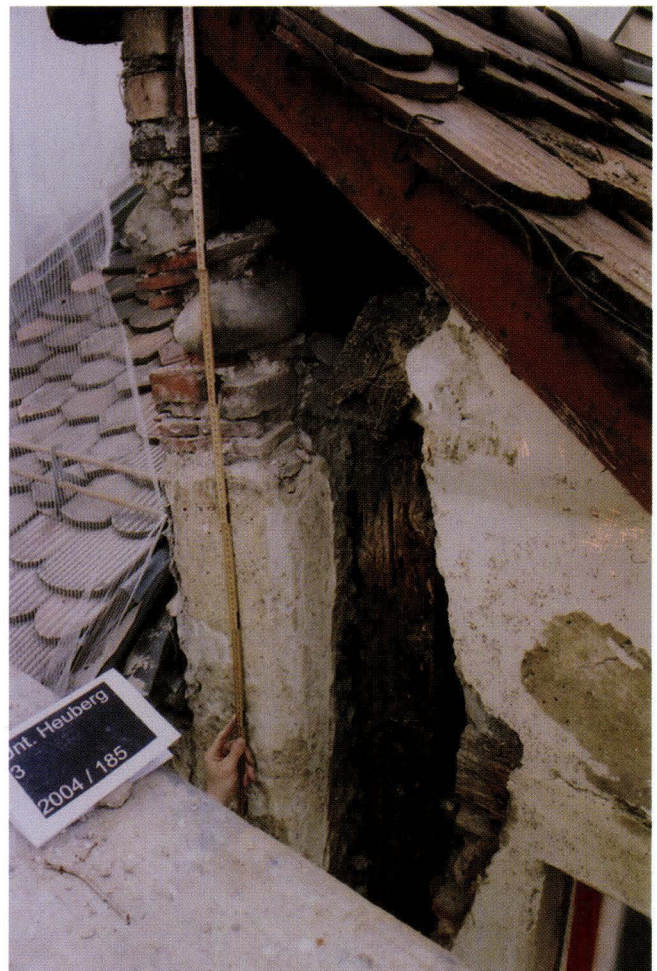
Abb. 17-3 Unterer Heuberg 3 (2004/185). Oberer Abschluss der talseitigen Giebelfassade. Der Eckständer und die vorkragende Firstpfette sind stark verwittert. Die Firstmauer ist zuoberst nur schwach ausgebildet. – Foto: Basler Denkmalpflege.
