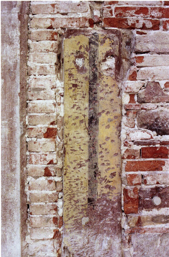
Abb. 11-16 Spalenberg 18 (2004/4). Strassenseitige Fassade, 1. Obergeschoss. Der obere Teil des zentralen Fensterpfostens trägt als letzte Fassung zwei verschiedene Ockertöne, welche offensichtlich den zwei Haushälften zuzuordnen und durch einen schwarzen Streifen voneinander abgetrennt sind. Ein erheblicher Teil der originalen Fensterflächen wurde beim Einbau der bestehenden Fensterrahmen vermauert. – Foto: Basler Denkmalpflege.
