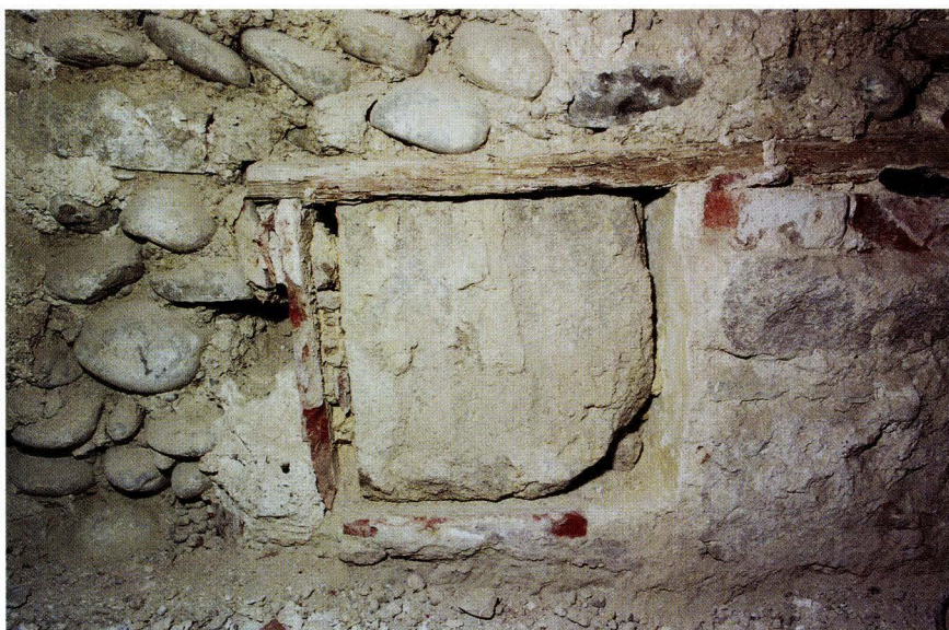
Abb. 14-3 St. Alban-Vorstadt 16 (2004/108). Erdgeschoss, westliche Brandmauer. Die verkleinerte Maueraussparung diente unter Beibehaltung des originalen Sturzbretts als Nische, bis sie schliesslich mit einem passgenauen Sandsteinquader vermauert wurde. – Foto: Basler Denkmalpflege.
