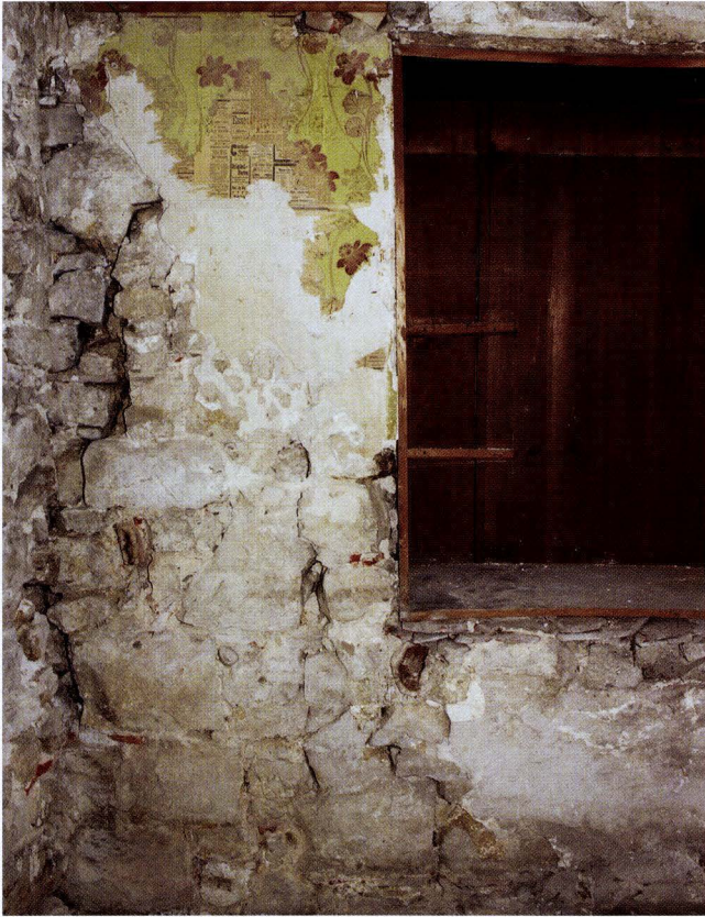
Abb. 10-22 Rössligasse 7, Riehen (2003/381). Aussenseite der alten Giebelfassade des Gebäudes von 1609. Ganz links die abgebrochene Mauer, die links die Hausecke zur Strasse formte. Daran anstossend ein sekundäres Mauerwerk, das eine Fensteröffnung ausbildet. Die Öffnung wurde später zum Wandkasten umfunktioniert. – Foto: Basler Denkmalpflege.
