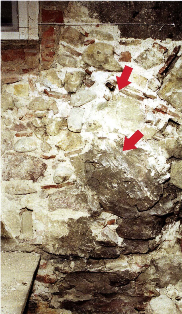
Abb. 15-4 St. Alban-Vorstadt 66 (2002/7). Zweites Obergeschoss, Blick gegen die östliche Brandmauer. Detail der freigelegten Dachlinie des älteren Dachs im Bereich des Dachfusses. Der obere, schwächer geneigte Abdruck zeigt die Position des äussersten Aufschieblings. – Foto: Basler Denkmalpflege.
