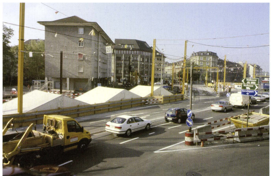
Abb. 15 Voltastrasse (A), TJO Süd, Etappe 2, 2003/38. Lage der Grabungszelte zwischen dem Verkehr und der Nordtangente-Grossbaustelle. – Foto: Doris Kähli Tanfutu.
