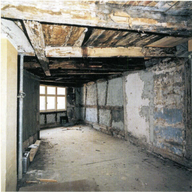
Abb. 5 Barfüsserplatz 23 (D 2001/12). Drittes Obergeschoss mit Blick gegen Osten. Links die Holztrennwand zur Gerbergasse 83. Rechts Flickstelle in der Fachwerkwand gegen Süden, am Ehgraben. – Foto: Basler Denkmalpflege.
