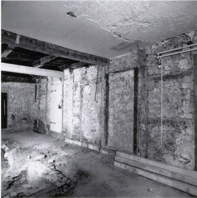
Abb. 24 Klosterberg 21 (D 2001/2). Blick in den Ladenraum. Rechts die in Fachwerk gebaute Trennwand zum Gang. Im Hintergrund die Quermauer mit dem zugemauerten Spitzbogen. – Foto: Basler Denkmalpflege.
