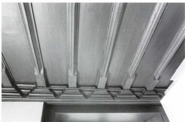
Abb. 72 Lohnhof. Pförtnerhaus, Erdgeschoss, Südraum. Gotische Bälkchendecke, das Kranzgesims mit verkröpften Profilen. – Foto: Basler Denkmalpflege.
