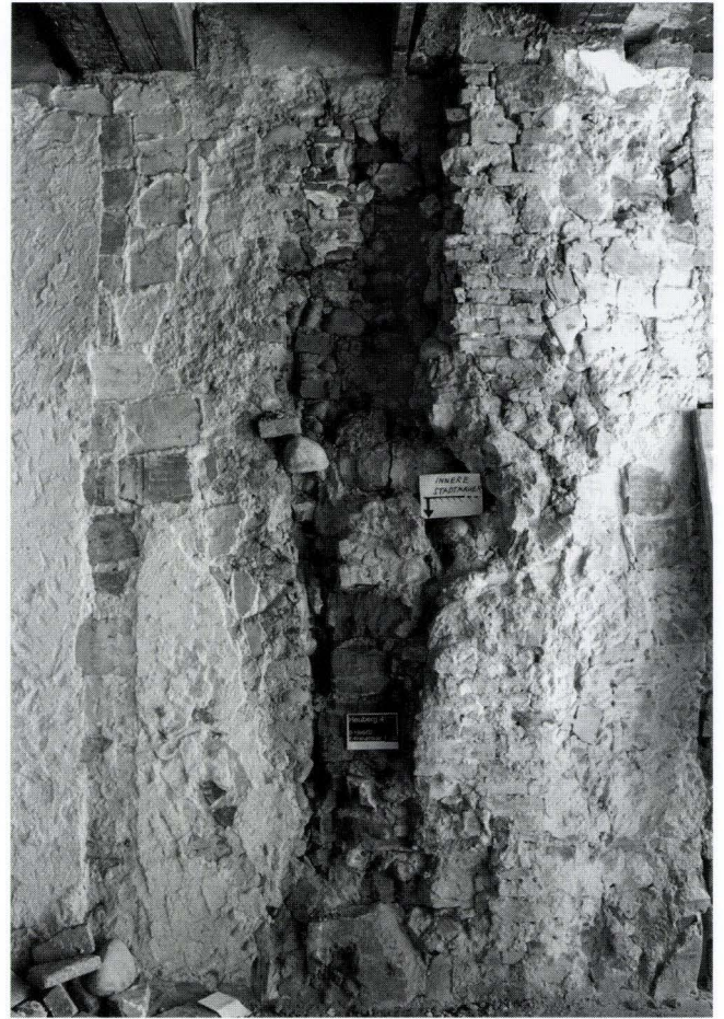
Abb. 7 Heuberg 4/Leonhardsgraben 21 (D 1999/02). Ostbrandmauer im Hinterhaus, 1.OG. Im Innern des Mauerwerks konnten Reste der Inneren Stadtmauer gefasst werden. Sie ist bis auf eine Höhe von 278.4 m ü. M. nachweisbar. – Foto: Basler Denkmalpflege.
