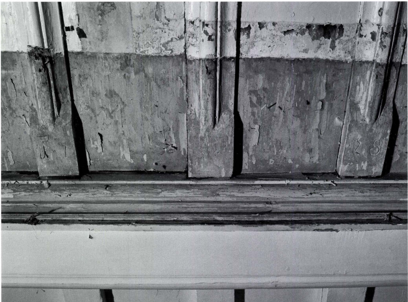
Abb. 16 Detail aus der Täferdecke im 1. Untergeschoss, mit der Gravur «17 ES 28». Zustand vor der Renovation. – Foto: Christoph Teuwen.
