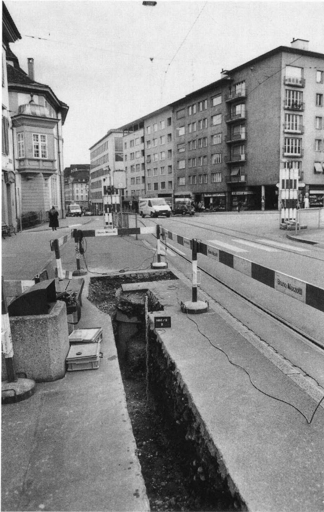
Abb. 2. Leitungsraben am Totentanz. In der rechten (südwestlichen) Grabenwand sind die römischen Gräber angeschnitten; Blick nach Süden.
