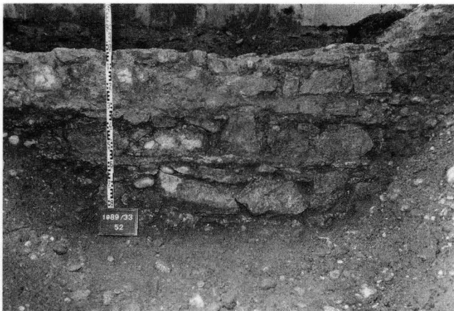
Abb. 8. Malzgasse 2, 1989/33. Mauercharakter der Rückseite der Vorstadtmauer MR 9 mit den signifikanten horizontalen Mörtelbrauen.
