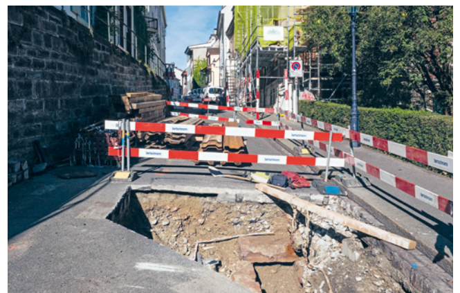
ABB. 25 Blick stadteinwärts, den Mühlberg hinauf. Unten rechts, neben dem Trottoirrand, ist der aufgedeckte Dolenkanal sichtbar. Foto: Martin Allemann.
