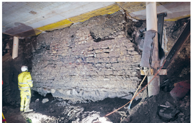
ABB. 26 Nur dank des Einsatzes von Kompressor und Druckluftlanze gelang es, die grossen Mauerflächen speditiv freizulegen. Foto: Birgit Lißner.
