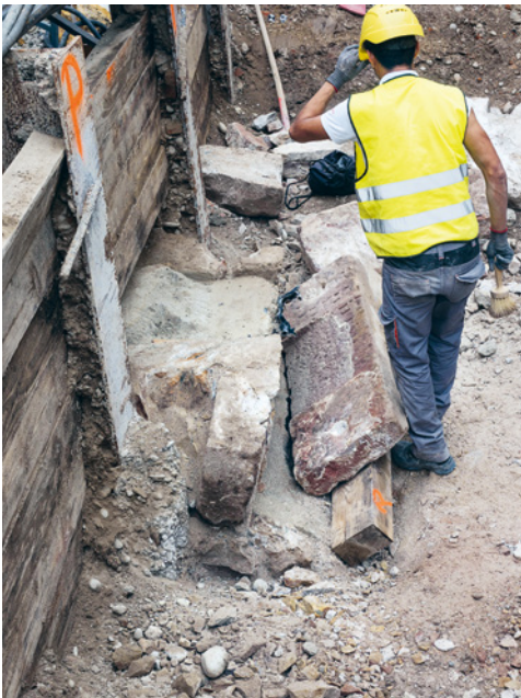
ABB. 17 Mit dosiertem Einsatz schwerer Werkzeuge gelang es, die Grabsteine unbeschädigt aus dem angeschnittenen Gewölbe (unten links) auszubauen, in das sie eingemörtelt waren. Foto: Martin Allemann.
