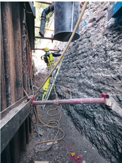
ABB. 6 Ein Stück der Aussenschale der freigelegten Inneren Stadtmauer wird vor der Dokumentation mit einer Druckluftlanze geputzt. Foto: Philippe Saurbeck.
