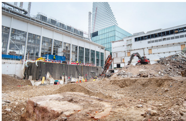
ABB. 43 Blick in die Baugrube während des Rückbaus von Bau 49. Im Vordergrund das Fundament des Industrieofens des ehemaligen Rohmaterial-Bahnhofs der Badischen Bahn. Foto: Sven Billo.
