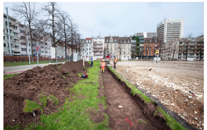
ABB. 33 Begleitung des maschinellen Aushubs eines Leitungsgrabens im Randbereich der Voltamatte. Foto: Margit Dauner.
