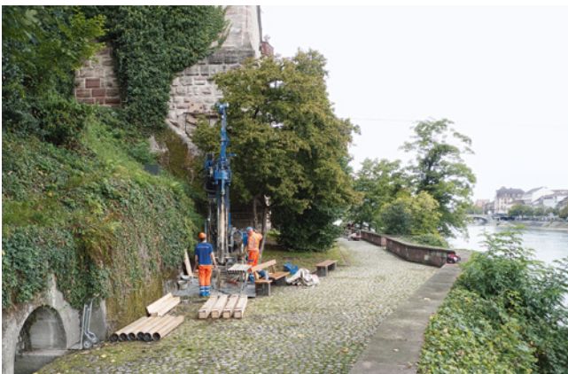
ABB. 3 Übersicht nach Norden mit der mächtigen Pfalzstützmauer links und der Bohrmaschine für die Sondierungen. Entlang der unteren Stützmauer (rechts) wurden zudem kleine Handsondagen geöffnet. Foto: Martin Allemann.
