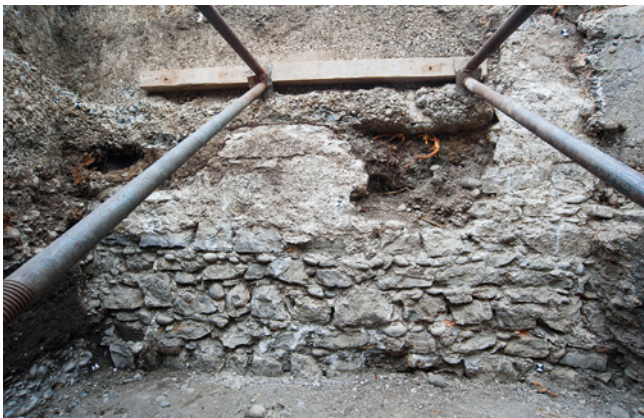
ABB. 17 Leitungskanal vor dem Tropenhaus. Im Graben selbst kamen keine Gräber zum Vorschein, aber direkt unter dem Weg im Vordergrund. Foto: Christian Stegmüller.
