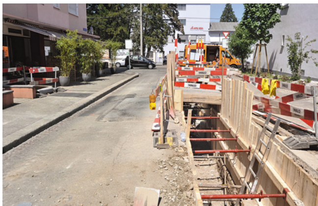
ABB. 40 Blick nach Nordosten über den Fernwärmegraben; die neu entdeckte Mauer befindet sich am rechten Grabenrand hinter der Leiter, am Fuss des Grabens. Foto: Christian Stegmüller.
