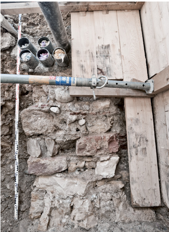
Abb. 22 Blick auf den malträtierten Fundamentrest des Aeschentors. Foto: Christian Stegmüller.
