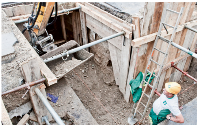
Abb. 37 Eine Strassenquerung für die Fernheizung zeigt im nicht verschalteten Bereich eben noch die verputzte Kellermauer eines längst abgebrochenen Gebäudes aus dem 19. Jh. Foto: Christoph Matt.
