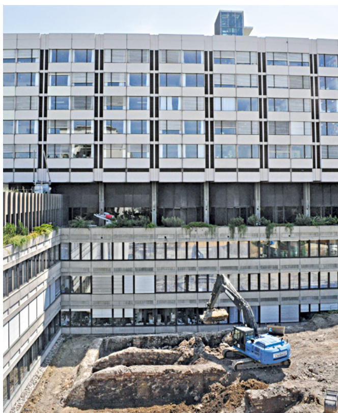
Abb. 45 Die vom Bagger freigelegten Fundamente des alten Spitals aus den Jahren 1838–42. Foto: Christoph Matt.
