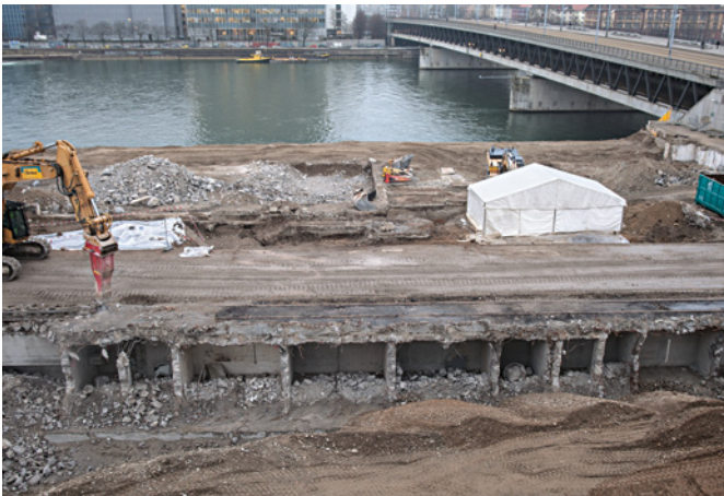
Abb. 56 Während im Vordergrund unterkellerte Bereiche des Coop-Silos abgebrochen werden, ist gegen den Rhein zu die Archäologie aktiv (Grabung 2010/42): links mit Plastikfolie geschützte lehmhaltige Zonen, daneben Fundamente abgebrochener Gasfabrik-Installationen. Foto: Michael Wenk.
