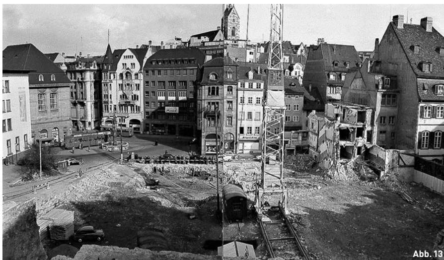
Abb. 13 Das «Storchenareal» am Fischmarkt/Stadthausgasse südlich des Spiegelhofes, nach Abbruch der Altstadt Häuser. Foto: StABS, Bildersammlung.
