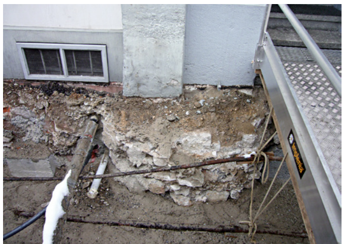
Abb. 31 Der halbe Stützpfiler am Haus «Zum Helfenberg» (Heuberg 20). Der Besitzer des Nachbarhauses «Zum Engelberg» (Nr. 18) liess die rechte Hälfte irgendwann beseitigen. Im Boden verblieb das Fundament in ganzer einstiger Pfeilerbreite. Foto: Christoph Matt.
