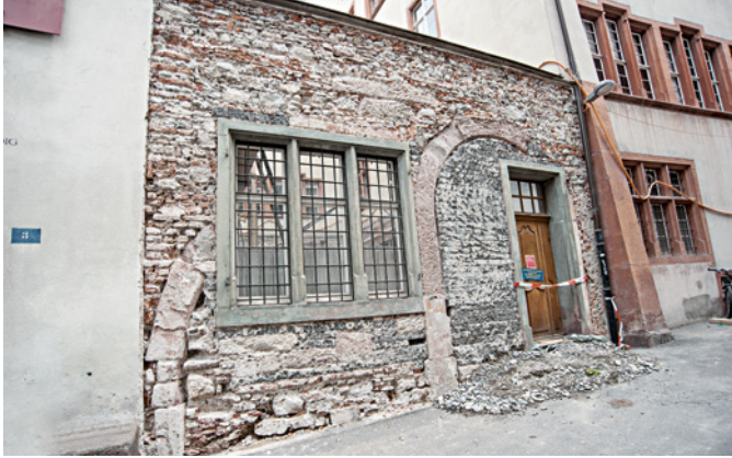
Abb. 20 Die vom Putz befreite Fassade zeigt die in den 1890er Jahren eingebaute Tür im vermauerten jüngeren Torbogen. Am linken Bildrand sind die Reste des Gewändes eines älteren Torbogens zu sehen. Foto: Jan Baur.
