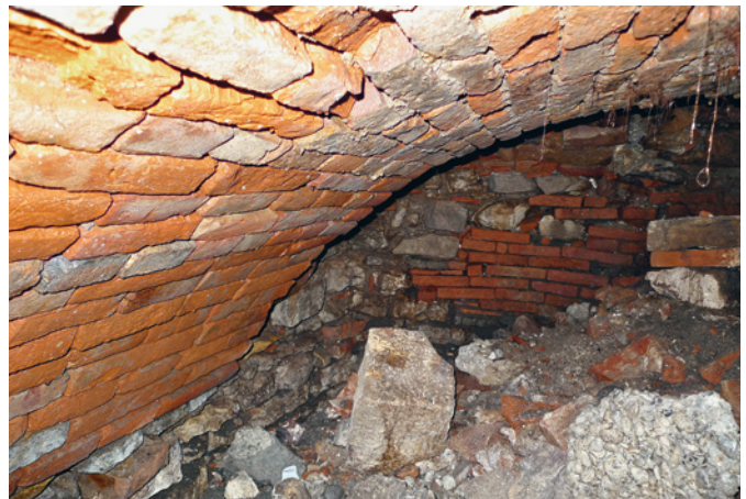
Abb. 10 Unterirdischer Raum mit Gewölbe aus Backsteinen, verfüllt mit Abbruchschutt. Foto: Sven Straumann.
