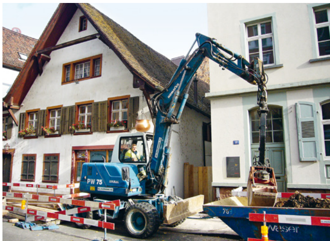
Abb. 41 Blick auf die Baustelle zwischen den Häusern Nr. 12 (rechts) und 14 (links). Foto: Christoph Matt.
