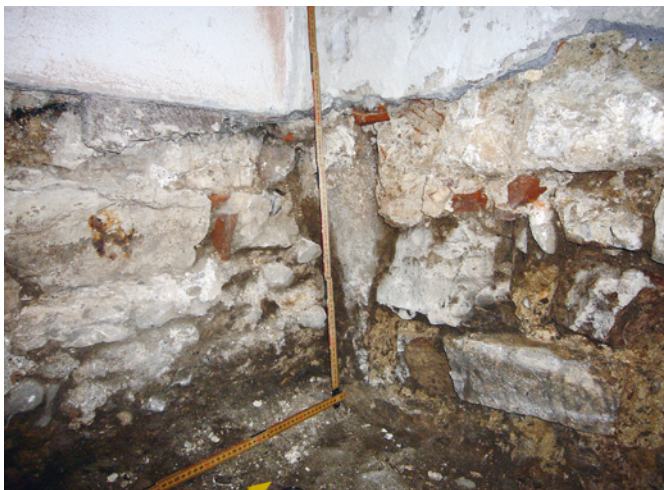
Abb. 36 Westlicher Seitenflügel: Blick nach Nordosten in die Ecke zwischen ältester Mauer (Hoffassade; rechts) und anstossender nördlicher Mauer (links). In der Ecke hinter dem Doppelmeter der zur ältesten Mauer gehörende senkrechte Türgewändestein. Foto: Christoph Matt.
