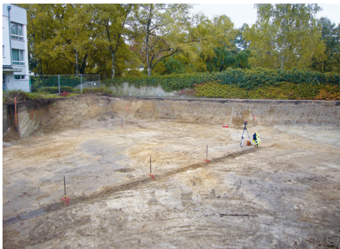
Abb. 50 Blick nach Nordwesten über die Baugrube zum Stumpgässlein. Die fragliche Grube liegt links vom Messgerät an der hinteren Baugrubenböschung. Foto: Christoph Matt.
