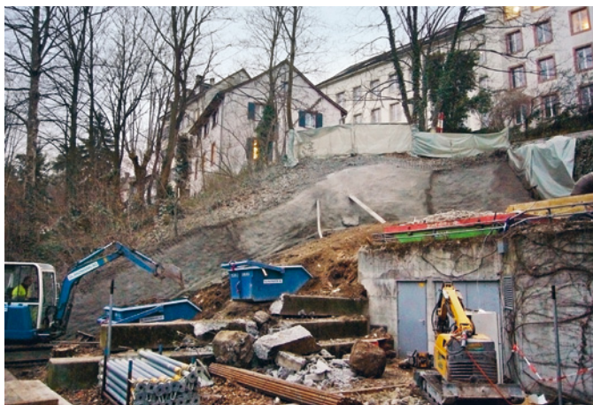
Abb. 29 Blick über die Baustelle östlich des langgezogenen Fabrikgebäudes am Fusse des Talhangs unmittelbar neben dem Gewerbekanal (dem «Dalbedyck»: links hinter dem Bagger, nicht sichtbar). Foto: Christoph Matt.
