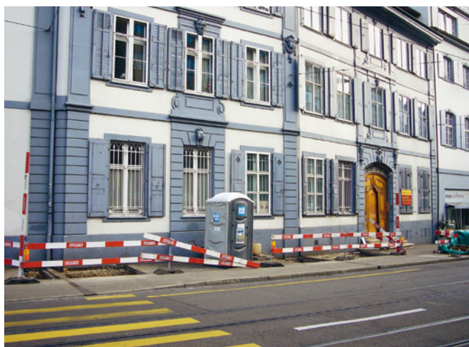
Abb. 42 Die Baustelle vor dem Seidenhof. Der ehemalige Torturm stand genau vor dem dreiaxigen Mittelteil des Seidenhofs in der linken Bildhälfte. Foto: Christoph Matt.
