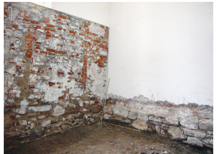
Abb. 37 Westlicher Seitenflügel: Blick auf die stark gestörte Mauer mit vielen Backsteinvormauerungen neben der Zufahrt (links), rechts die junge Zwischenmauer. Foto: Christoph Matt.
