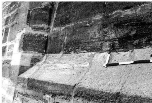
Abb. 16. Mittleres Kaffgesims in der nordwestlichen Hälfte der Pfalzmauer mit Eisenmörtel in den Fugen. – Foto: BaDpfl.
