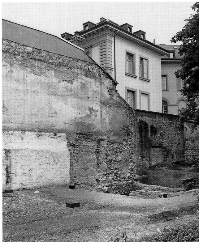
Abb. 1. Rittergasse 29/31. Die südliche Brandmauer nach Abbruch der Remise, Blick von Norden. – Foto: BaDpfl.
