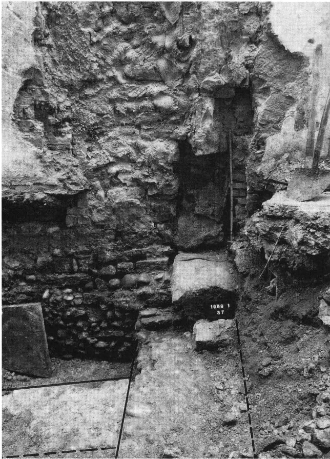
Abb. 10. Phase 3: Ansicht des Türgewändes am westlichen Ende der Südmauer von Kernbau II (siehe Abb. 4,c). Das untere Sandsteingewände und die halbe Schwelle (über der Fotonummer) sind noch in situ; die westliche Fassadenmauer unter der Schwelle sowie die Gangmauer sind angedeutet (Zustand während des Abbruchs). – Foto: AB, 37.
