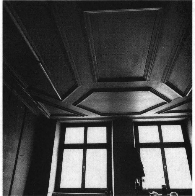
Abb. 6. Phase 6: barocke Täfeldecke im ersten Obergeschoss, Raum gegen die Weisse Gasse zu. Die Wände waren mit einfachen Brettern vertäfelt. – Foto: Basler Denkmalpflege, G 225-11.
