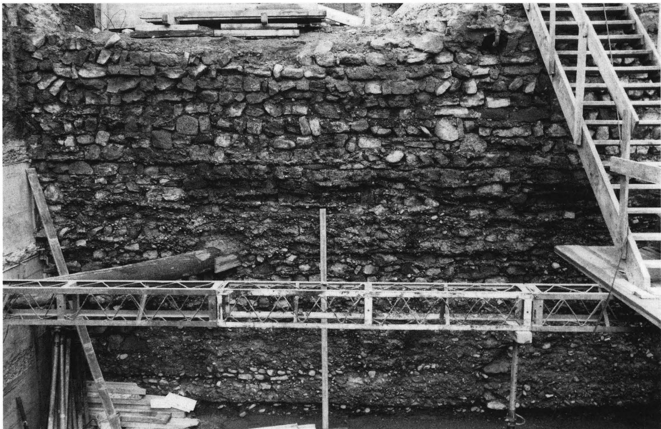
Abb. 5. Blick (gegen Westen) auf die Innenseite der Stadtmauer. Das obere Drittel der Stadtmauer ist frei aufgezogen (entspricht Abb. 4,B), der untere Teil gegen das Anstehende gemauert (Abb. 4,A). Die Abbruchkante liegt etwa auf Höhe des heutigen Strassenniveaus.
