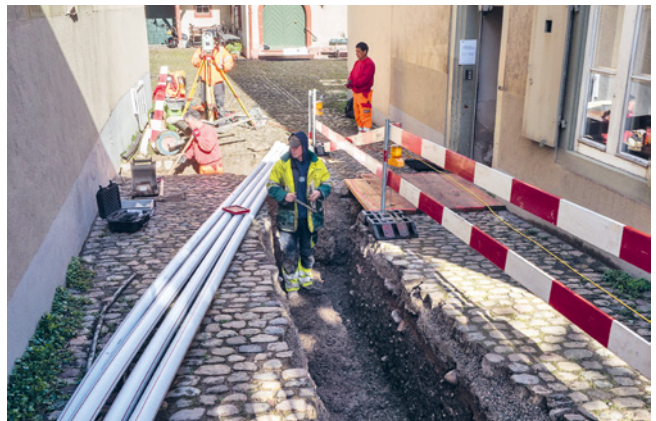
ABB. 20 Übersicht über den Leitungsgraben in der Hofeinfahrt mit Blick nach Westen zum Innenhof und Kernbau. Foto: Fabian Bubendorf.
